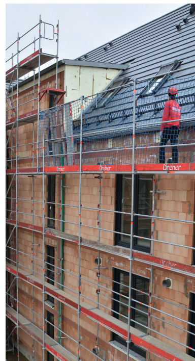
Construcción de edificio con nivel de trabajo en el borde del tejado.
